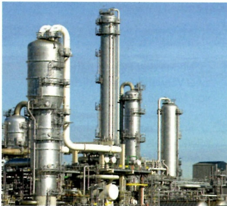
5 Destillationstürme in einer Raffinerie
